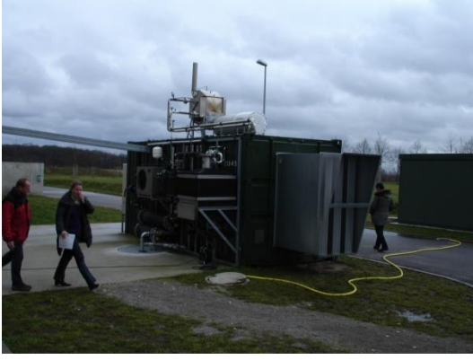
Fotoğraf 44 Kojenerasyon ünitesi
