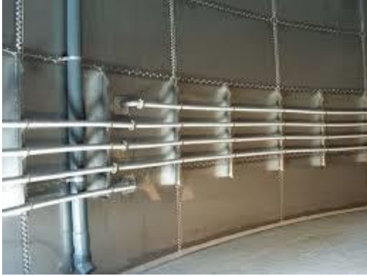
Fotoğraf 35 Çürütücü ısı değiştirici boruları
