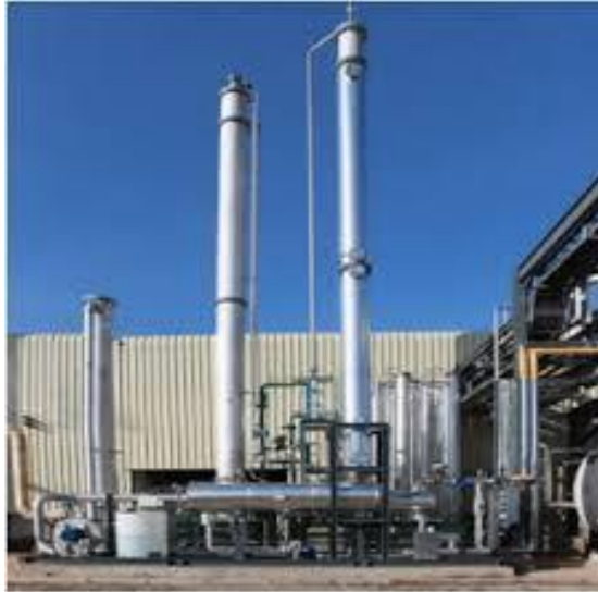
Fotoğraf 29 Su ile temizleme tesisi
