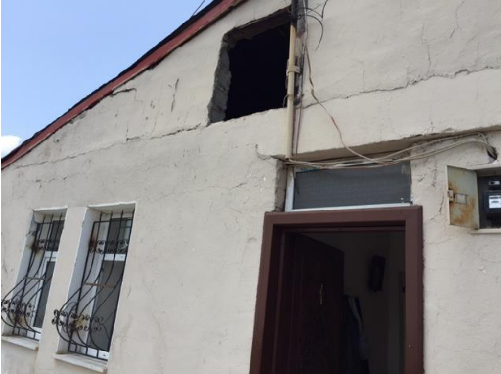
Fotoğraf 9 Çatı aralığında doğrama yerleştirilmemiş pencere boşluğu
