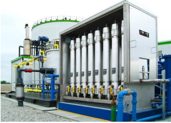
Fotoğraf 30 Membran gaz temizleme ünitesi
