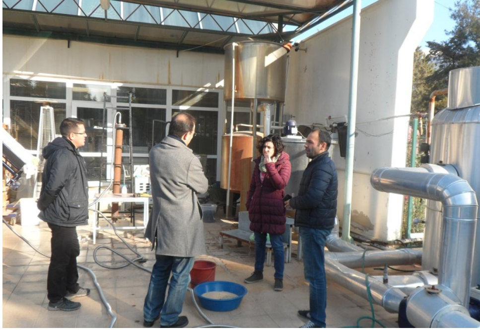
Resim 11: Güneş Enerjisi Enstitüsü prototip biyogaz tesisi
