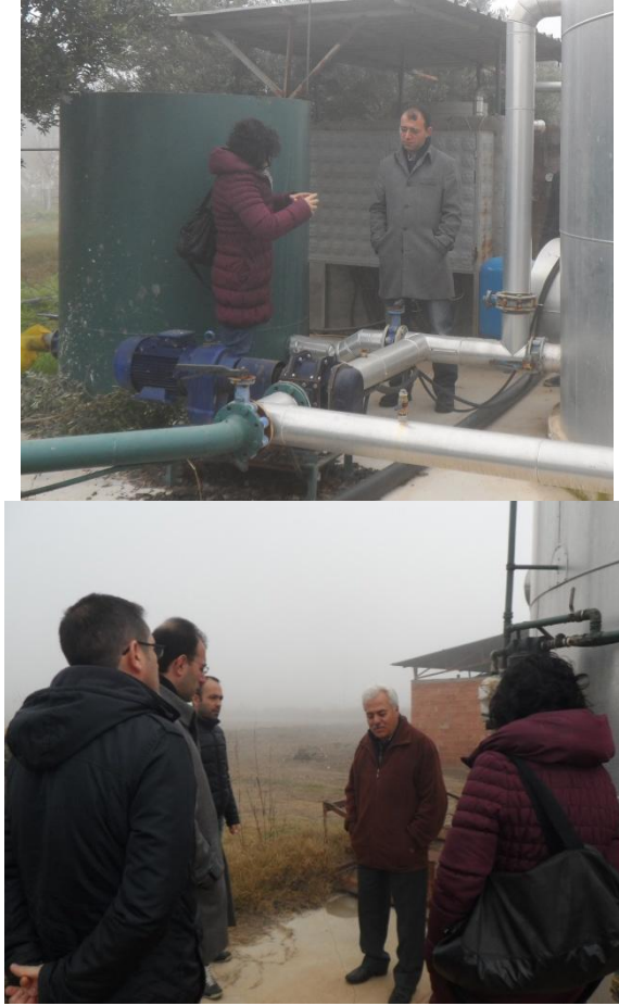
Resim 14: Torbalı ev tipi biyogaz tesisi 3
